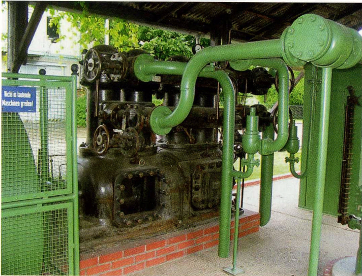
Kälteanlage aus dem Buna-Werk Schkopau mit zweistufigem Ammoniak- verdichter
